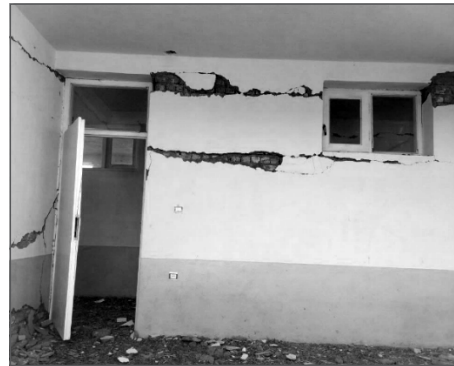
تصویر ۳۱: نمونه از کیفیت بتن در روستای زلزله زده سیا آب
