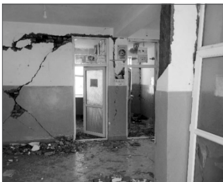
تصویر ۳۶: نمونه از کیفیت بتن در روستای زلزله زه سیا آب
