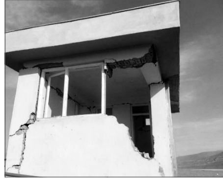
تصویر ۲۹: نمونه از کیفیت بتن در روستای زلزله زده سیا آب
