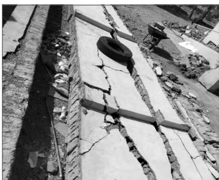
تصویر ۲۸: عدم کلاف بندی دیوار با تیر زمینی
