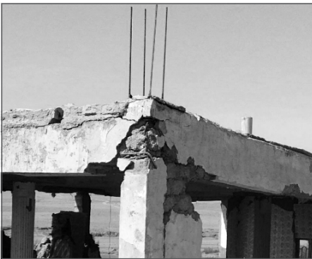
تصویر ۲۴: نمونه از شکست فوق در ساختمان بتنی روستای کشکک
