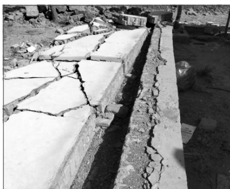
تصویر ۲۷: عدم کلاف بندی دیوار با تیر زمینی
