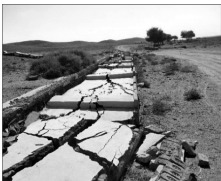
تصویر ۲۶: تخریب دیوار محوطه بخاطر عدم کلاف بندی درست در امتداد دیوار
