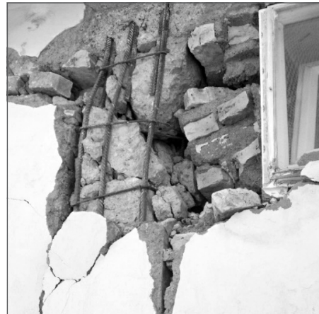
تصویر ۱۷: عدم رعایت فاصله خاموت‌های ستون در ساحه زلزله زده
