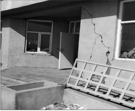
تصویر ۳۰: نمونه از کیفیت بتن در روستای زلزله زه سیا آب
