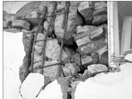
تصویر ۱۱: آسیب شدید ساختمان بتنی در روستای وردک ها ولسوالی زنده جان
