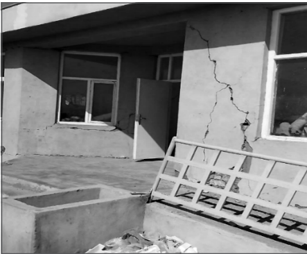
تصویر ۳۲: نمونه از کیفیت بتن در روستای زلزله زه سیا آب
