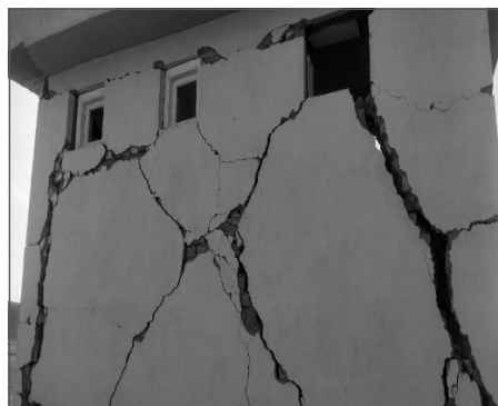
تصویر ۳۳: نمونه از کیفیت بتن در روستای زلزله زده سیا آب
